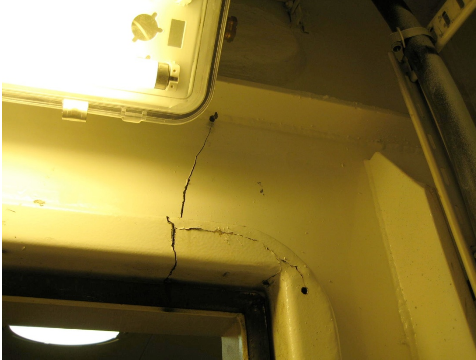
Şekil 2.1 Boyuna perdedeki açıklıklar – kapı çerçevesi civarındaki bir çatlak
